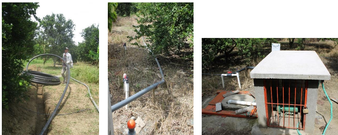
a. Sistema de bombeo y conducción de agua en el lote.
