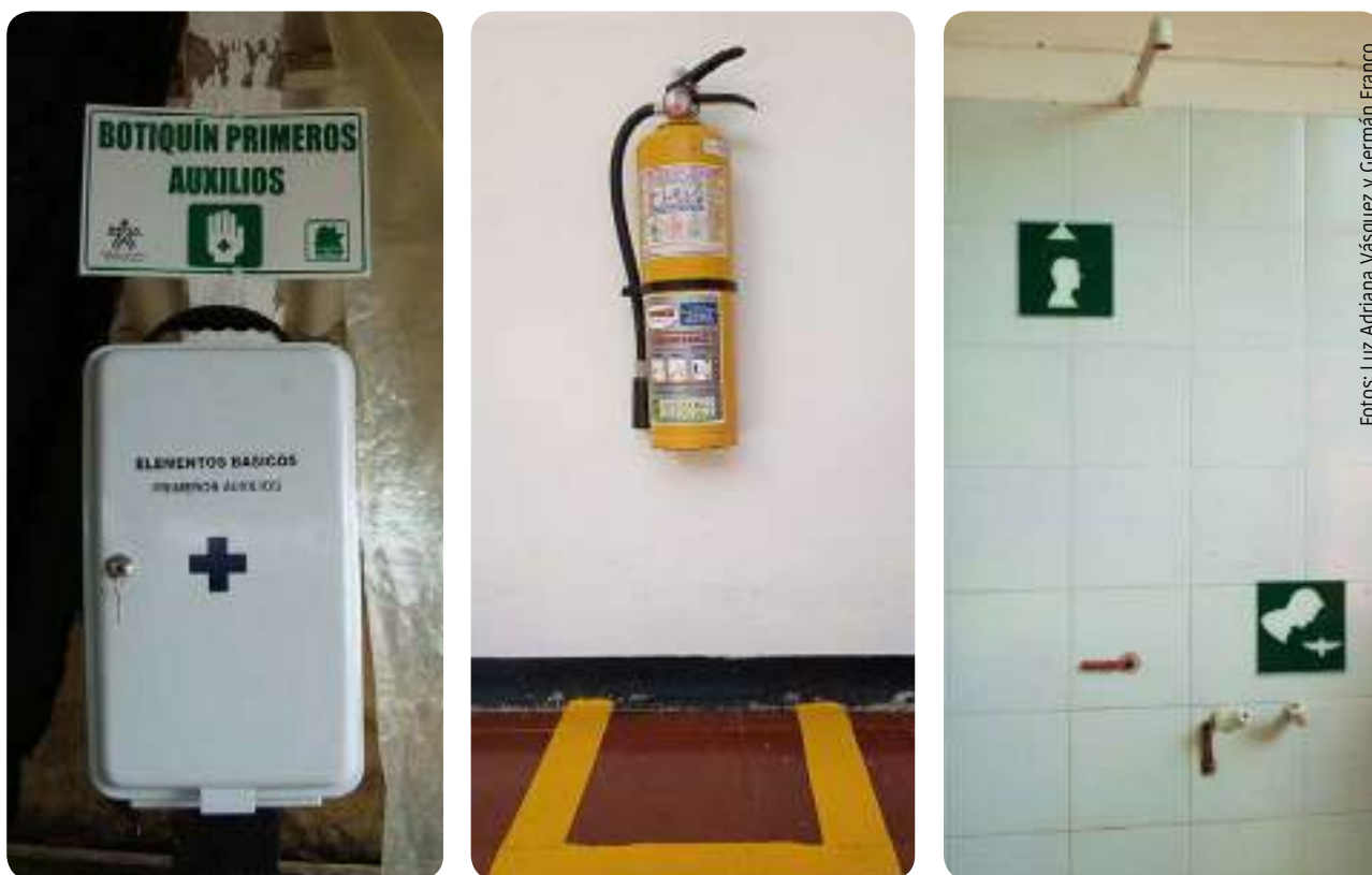
Figura 160. Otros requerimientos de la norma BPA. a. Botiquín; b. Extintor; c. Duchas para cuerpo y ojos.
