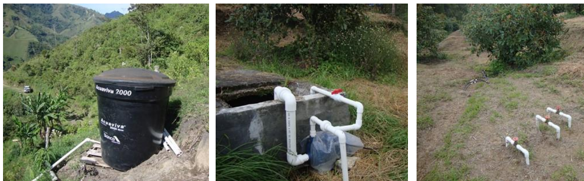
a. Dispositivos de bombeo y conducción de agua en el lote.
