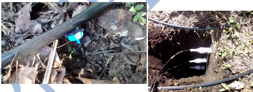
c. Goteros instalados en las líneas de distribución de agua en la zona de raíces de los árboles y sensores de humedad del suelo.
