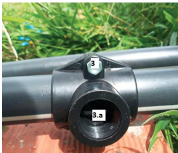
Figura 8.10. Derivación a línea de aspersores.
