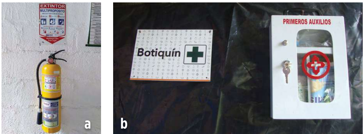
Figura 11.10. Elementos de protección. a. Extintor en un lugar visible; b. Botiquín de primeros auxilios.
